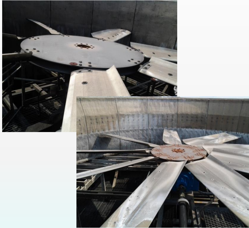
直徑 7.925M 冷卻塔風車扇葉(2014. 03. 21)
